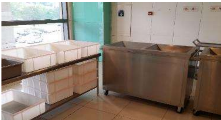
图 20 餐厨垃圾回收装置
