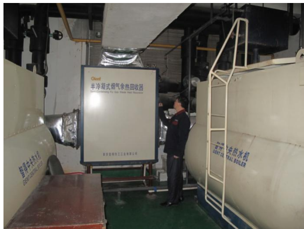
图 5 中央空调采暖锅炉烟箱图
