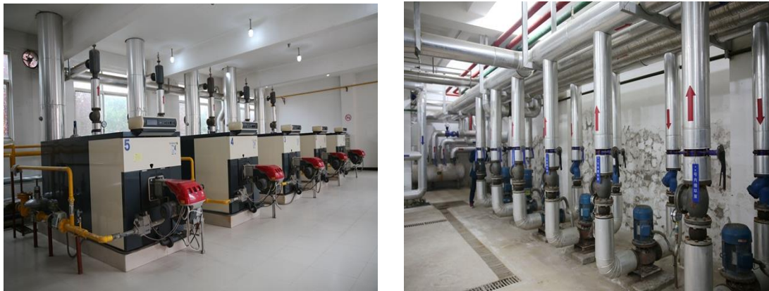
图6 锅炉效率提升改造后现场照片
