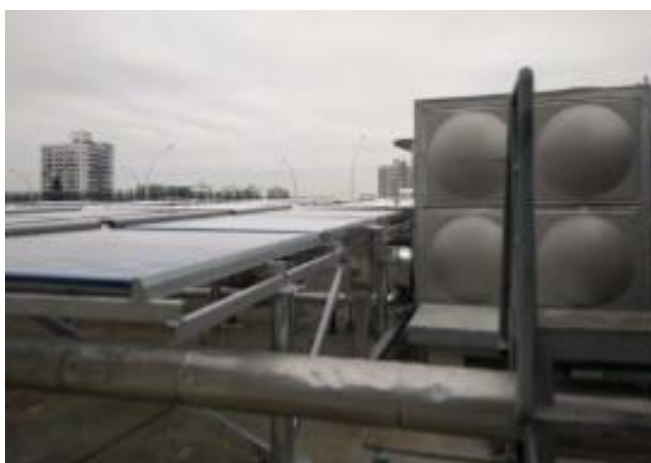
图 2 综合楼太阳能热水系统
