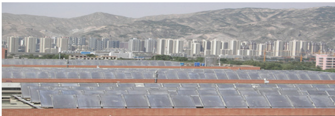
图 6 西校区学生公寓楼顶太阳能安装俯视图
