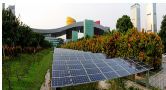
图4 太阳能光伏发电系统
