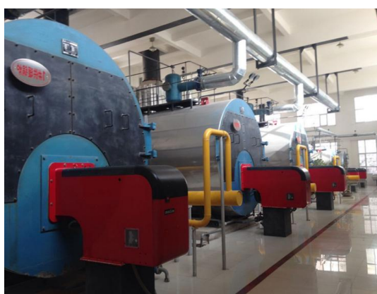
图 10 校本部燃气锅炉房
