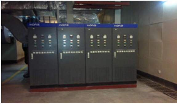
图2 恒温恒湿机组节能控制柜
