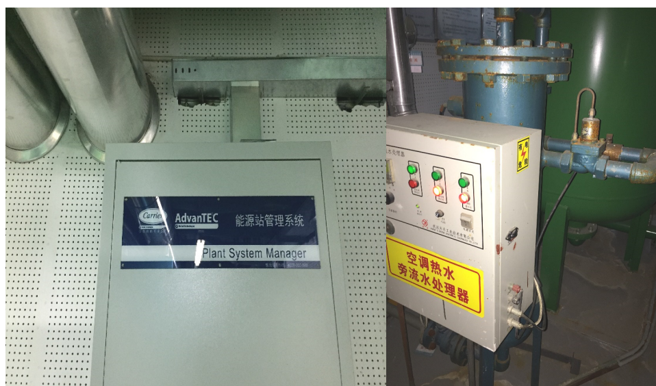
图 7 中央空调节能群控系统
