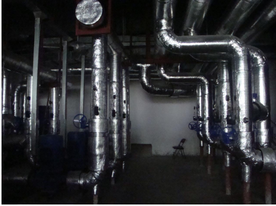
图 2 体育场中央空调机房
