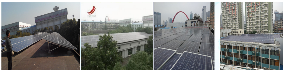
图 18 体操馆屋顶太阳能光伏电站
