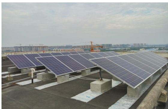
图 12 光伏发电教学楼屋顶
