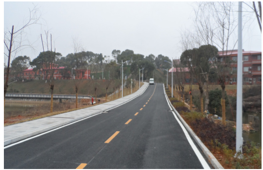
图 12 重竞技中心 LED 行道灯
