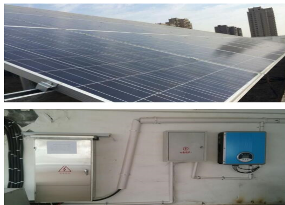
图 6 政务大楼光伏发电项目
