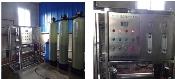
图 5 学校安装的直饮水机组
