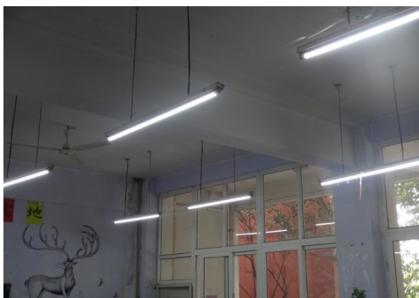
图 6 学校教室安装的 LED 节能灯管
