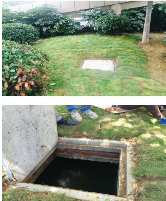
图 5 政务大楼雨水收集系统
