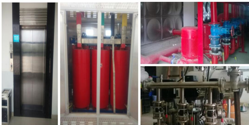
图 12 配电、电梯、水泵
