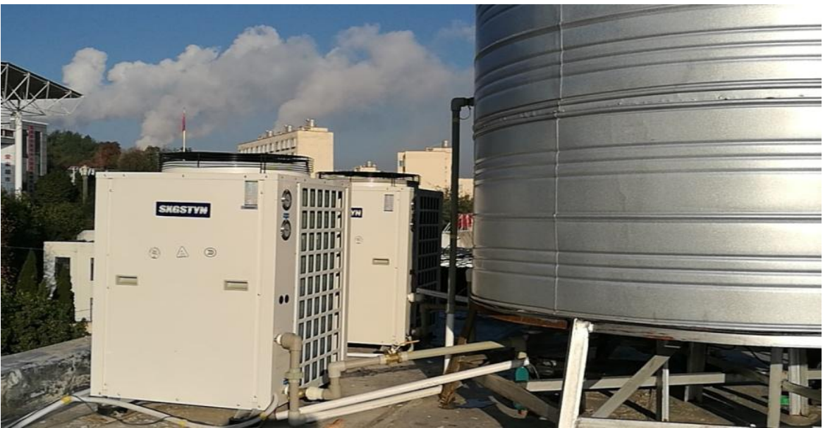
太阳能+空气源热水系统
