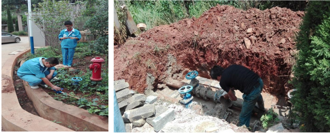
安装水表进行水量平衡测试
